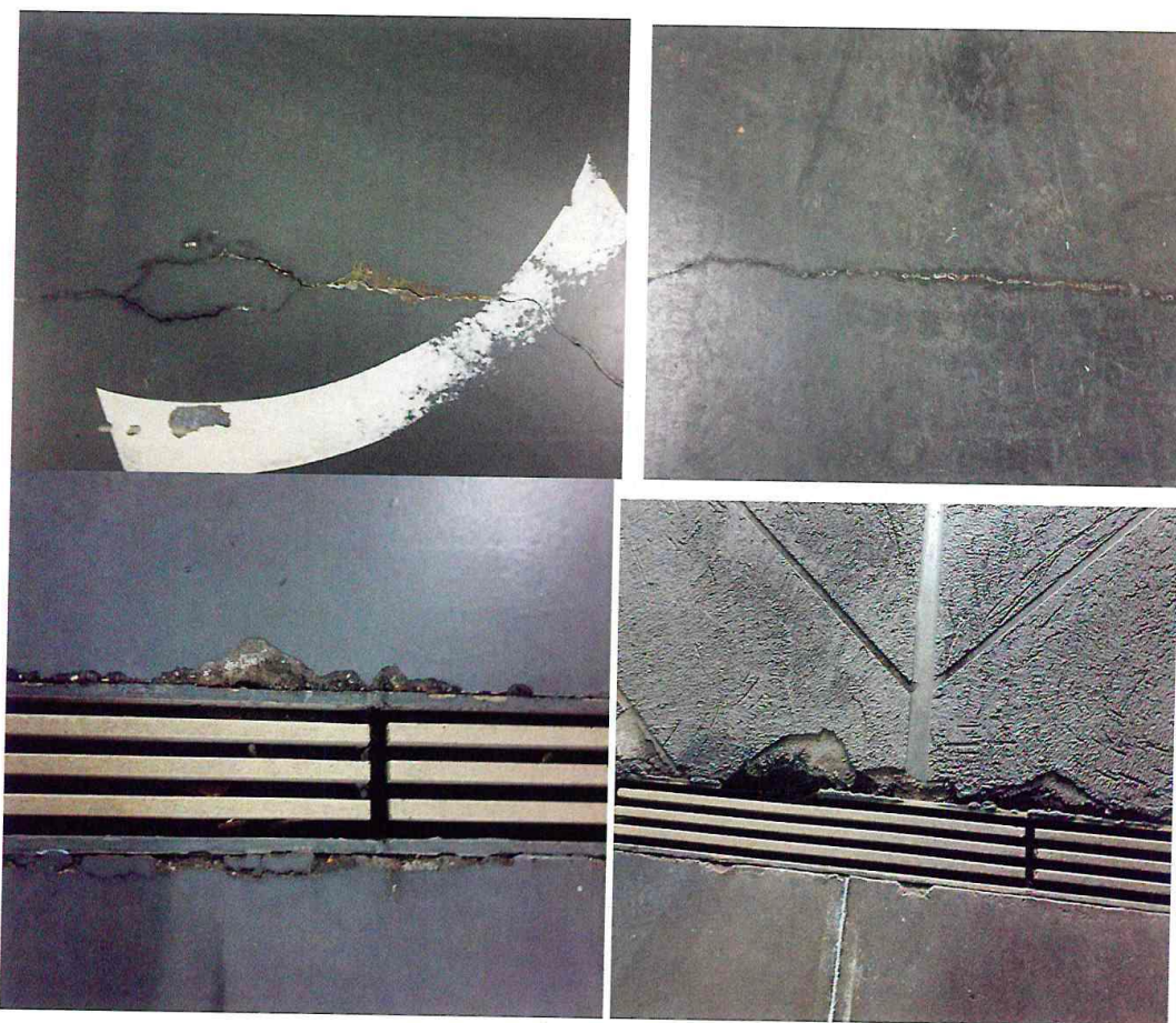
Oštećena epoksid podloga u garaži kod ulaza u garaži, rampa A4, A6, slikano 21.02.2022.
