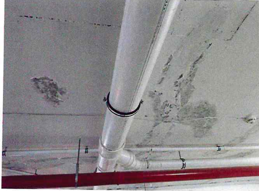
Prilog 3: razna oštećenje plafona
