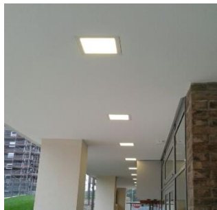
Led rasveta na bloku.
