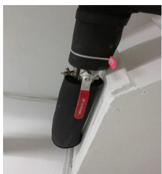
Ventili za sanitarnu i baštensku mrežu.
