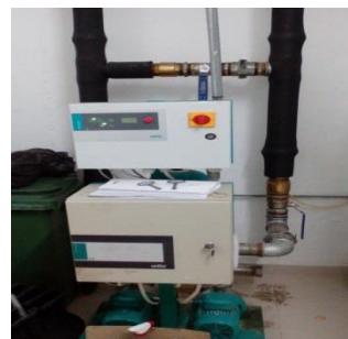
Uređaji za povišenje pritiska sanitarne instalacije.
