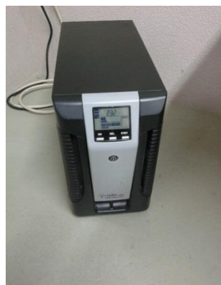
UPS (video nadzor i kontrolna soba)
